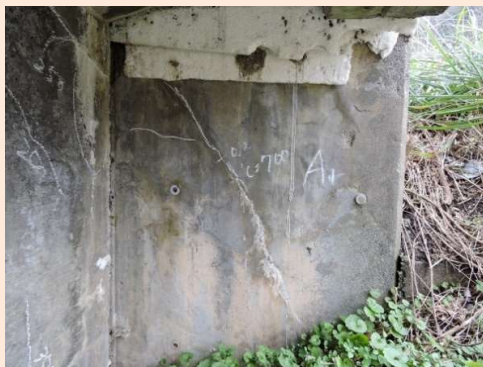
下部工のひび割れ
