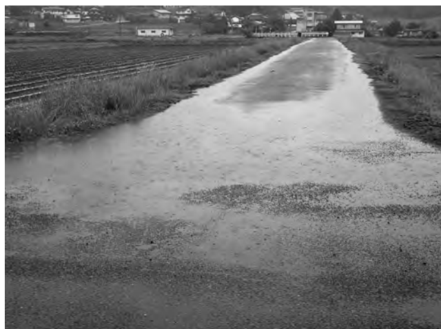
▲路面が冠水した農道（河原地内）
