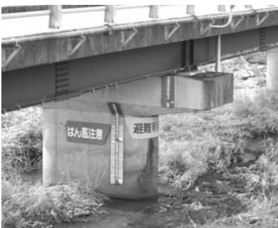
定点カメラで見る東吉田水位計
