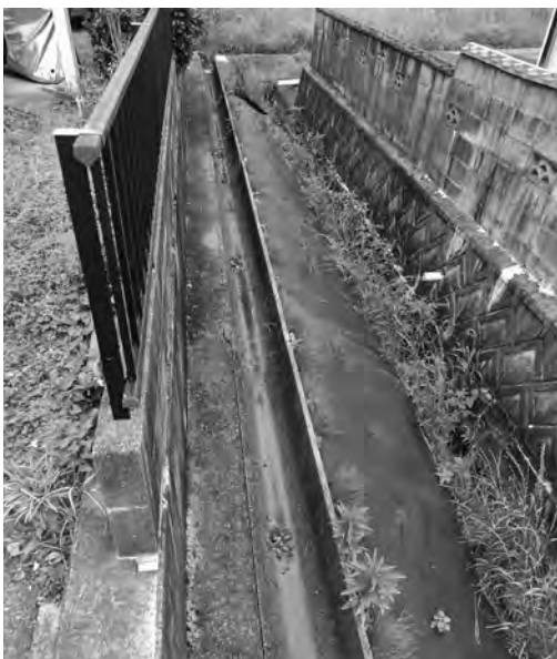
▲管理責任があいまいな宅地隣接の農業用排水路
