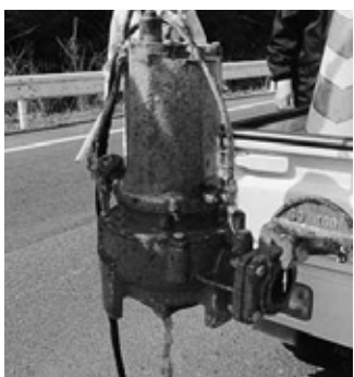
▲異物が詰まり故障したポンプ
