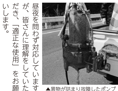
▲異物が詰まり故障したポンプ
